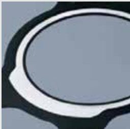
ガスケットの表面剥離
